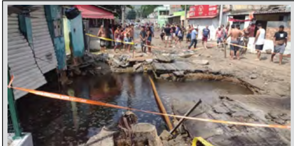
Rompimento de uma adutora causou estragos na Zona Oeste do Rio
