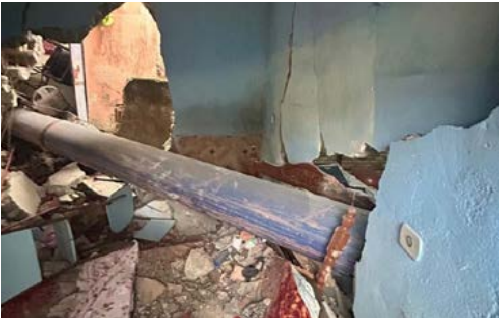
Tubulação da Sabesp atravessou a sala onde a idosa estava sentada
