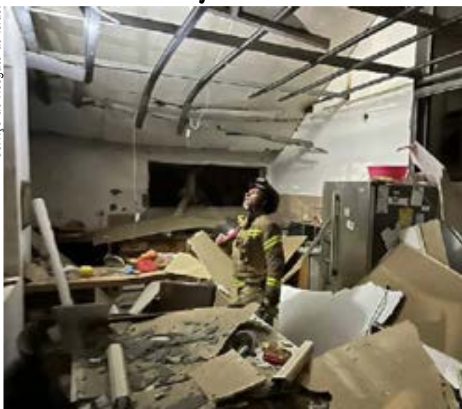
Bombeiros vistoriam prédio atingido em Dimona
