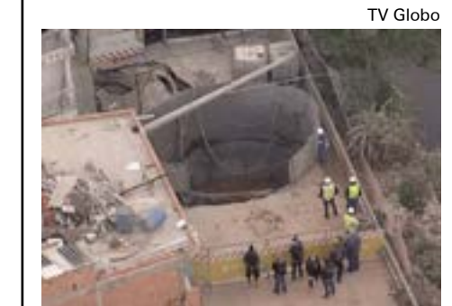
Cratera se abriu na obra da Sabesp
